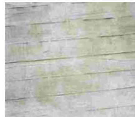
Kaba tahta kalıp dokusu tamir edilen alanlarda yeniden yapılabilir.
