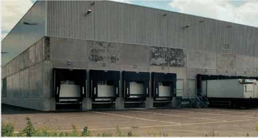
Cephede görülen yoğun lekelenme
