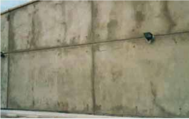
Ađır lekeli yeni beton
