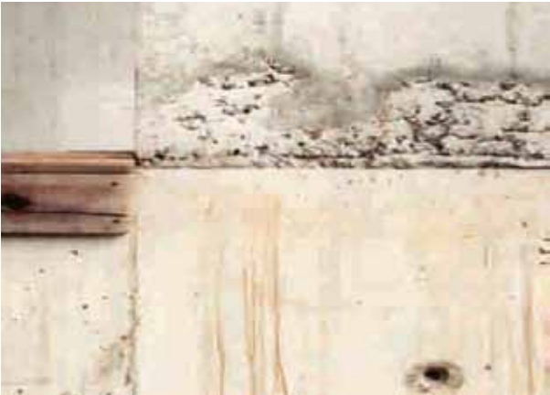
Sıva Kusurlarıyla dolgu gerektiren yeni beton
