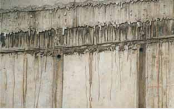
Sıva Kusurlarıyla dolgu gerektiren yeni beton
