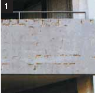
1 Yetersiz korunan betonda tipik bir bozulma örneği
